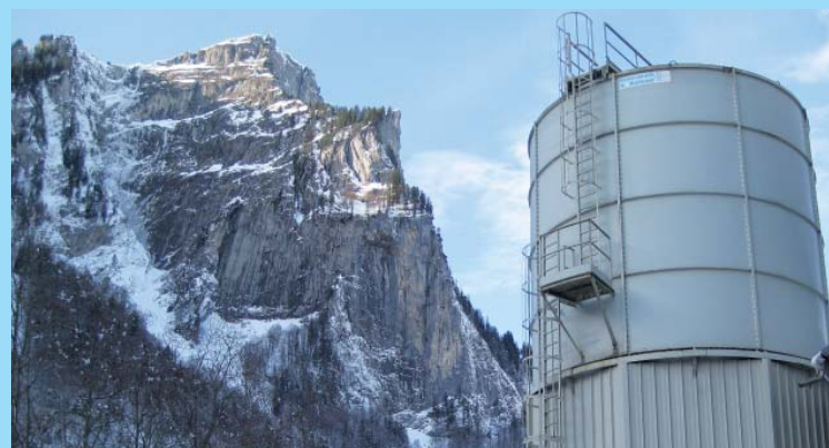
Kläranlage F&B mit Klärturn 6 m und Kammerfilterpresse
