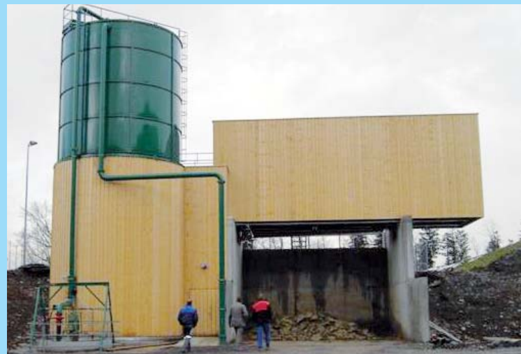
Kläranlage F&B mit Klärturn 7m und Kammerfilterpresse mit Waschroboter
