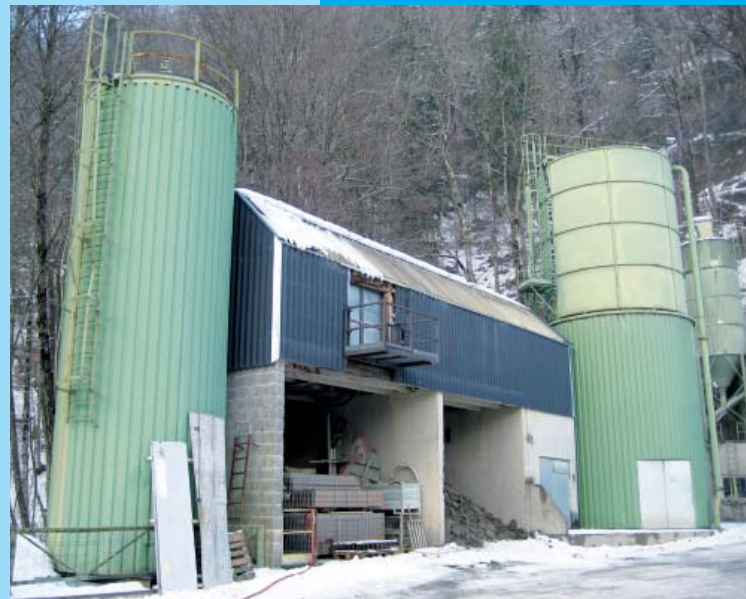
Kläranlage F&B mit Klärturn 5m und Kammerfilterpresse
